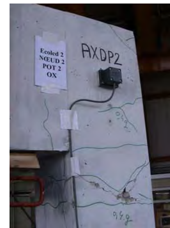
Ρηγμάτωση υποστυλώματος (μετά το πείραμα των 0.4 g)
