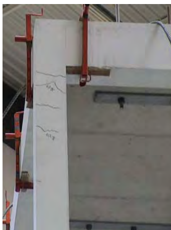
Ρηγμάτωση υποστυλώματος (μετά το πείραμα των 0.2 g)
